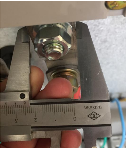
主母线宽度照片
